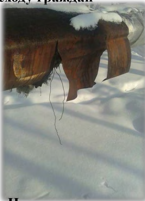
Не утепленные участки теплосетей
